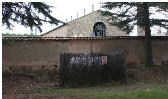
Depósito de gas
